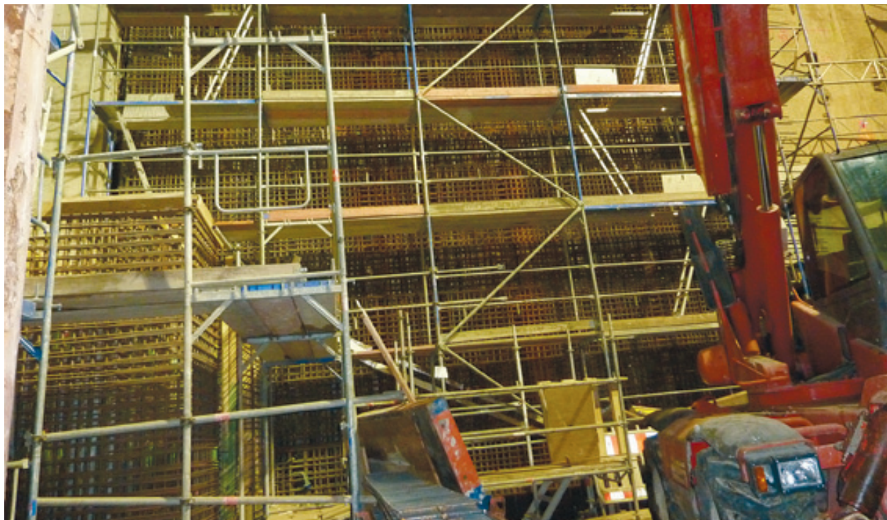
U-Bahn-Baustelle am Heumarkt: Die Stadt hatte die Bauaufsicht an den Bauherrn, die Verkehrsbetriebe übertragen.
